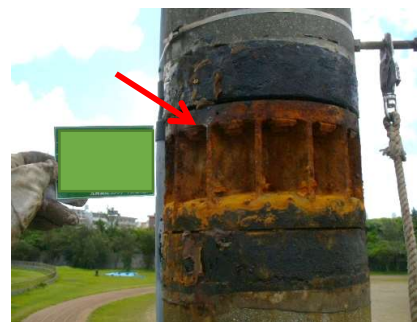
■ 継手部の発錆
