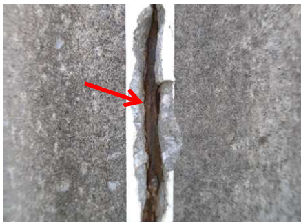
■ 内部鉄筋の腐食
